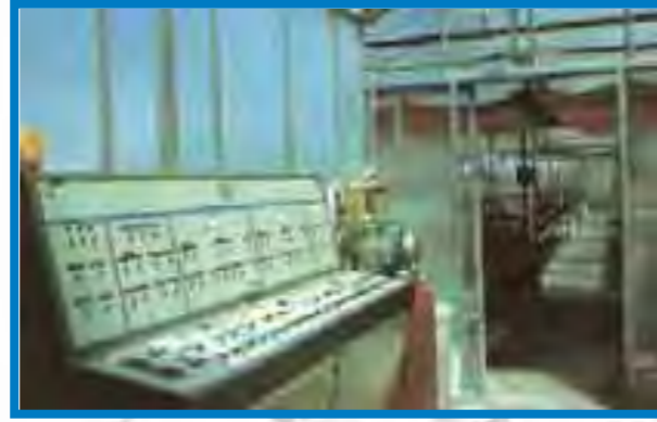
ARMARIOS DE MANDO CONTROL CONSOLE TABLE
