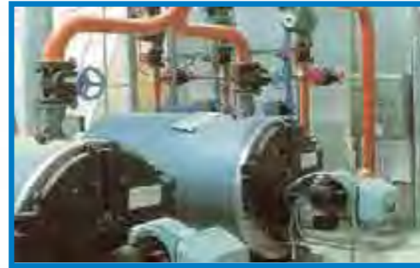
CENTRAL DE PRODUCCIÓN DE AGUA CALIENTE HOT WATER PRODUCTION POWER STATION
