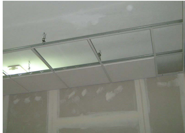
FALSO TECHO PLACAS PERFILERIA VISTA
