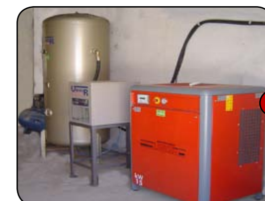
F. Sala de compresión y filtrado de aire. (equipos opcionales)
