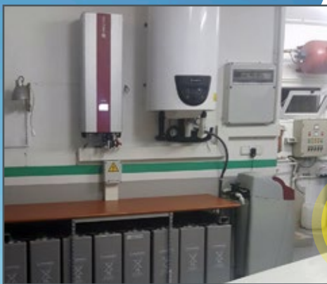
Vista de los equipos de acumulación y conversión de energía de una instalación.
