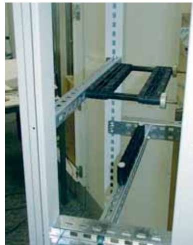
En la parte superior de la foto, detalle del soporte del embarrado UC824 (para embarrado vertical) y en la parte inferior detalle del soporte para extremo de barras en embarrado vertical (UC825).
